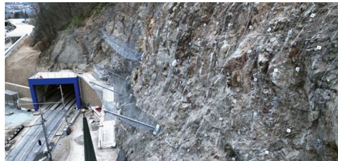
Dynamické bariéry, Brno, Česká republika
