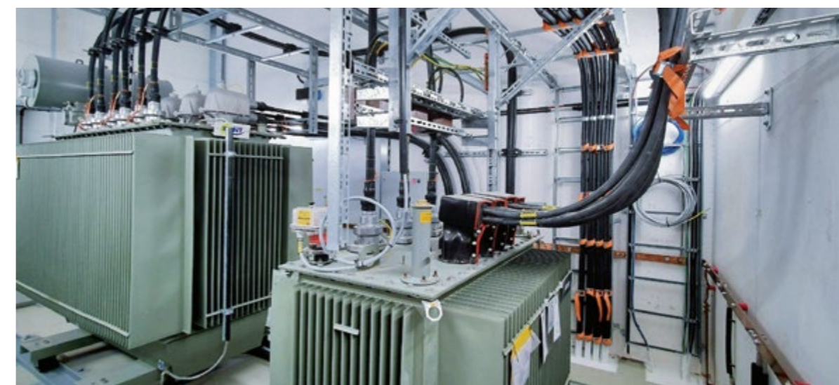
Elektroinstalace, elektrárna Töging, Německo
