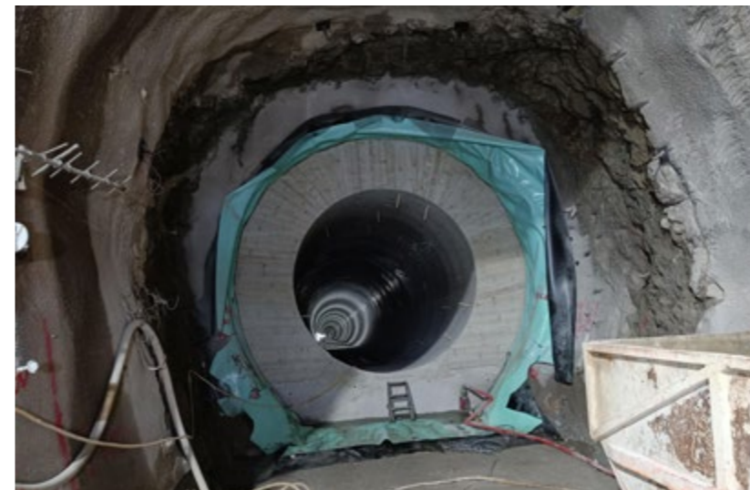
Potrubi elektrárny Tauernmoos, Rakousko
